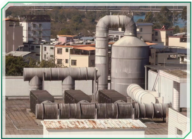
河源廠房 HYN2 廢氣收集淨化設施
