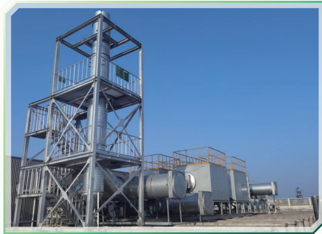
成都廠房車間廢氣收集淨化設施
