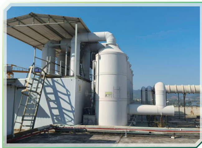
河源廠房 HYN1 廢氣收集淨化設施
