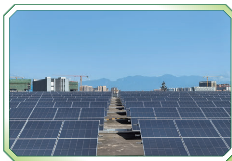
產線屋頂光伏發電站
