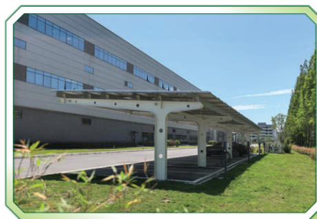
產線光伏停車棚
